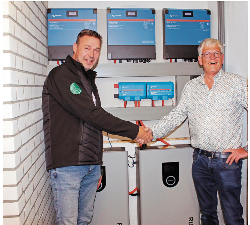
Het batterij/accusysteem is in de kelder geplaatst
