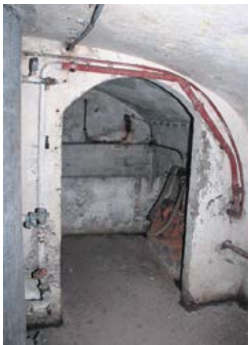
De oude waterinstallatie
